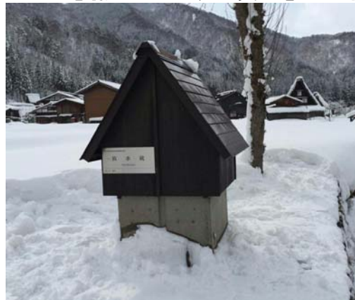
【放水銃や消火栓の除雪を】
