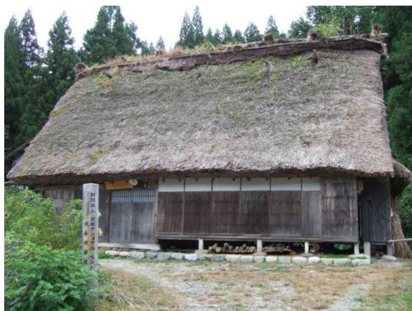
【裏手の屋根の傷みが激しい旧寺口家】
