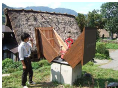
【新設される桃割れ式の放水銃格納箱】
